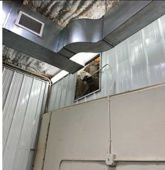
Sidewall Exhaust Fan
